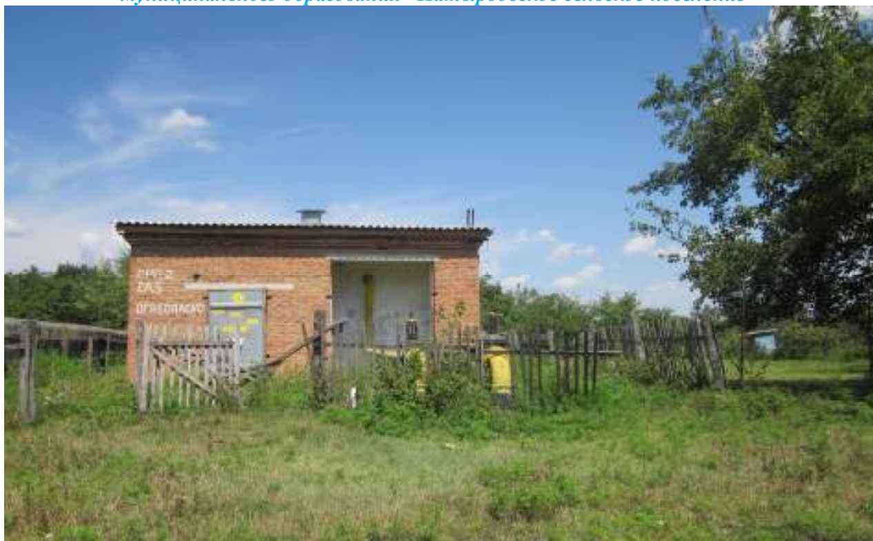
ГРП. с.Натырбово. ул.Ленина. Забор разрушен
