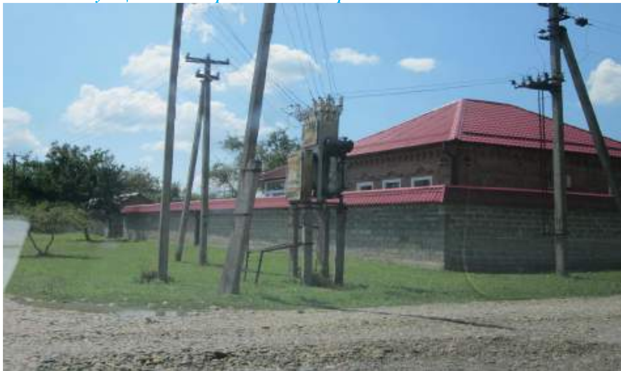
Трансформаторная подстанция-100 кВт. с.Натырбово. ТП не покрашен, замаслен. Столб кривой.
