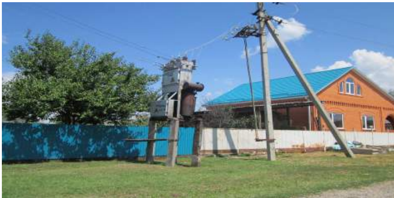
Трансформаторная подстанция – 100 кВт. ул.Ленина и Кирова. ТП замаслен, ржавый. Отсутствуют надписи. Скрутки.
