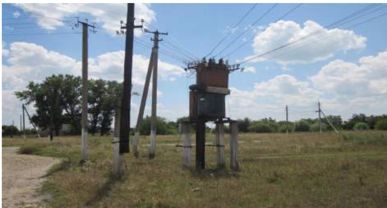
Трансформаторная подстанция- 100 кВт. п. Казенно-Кужорский
