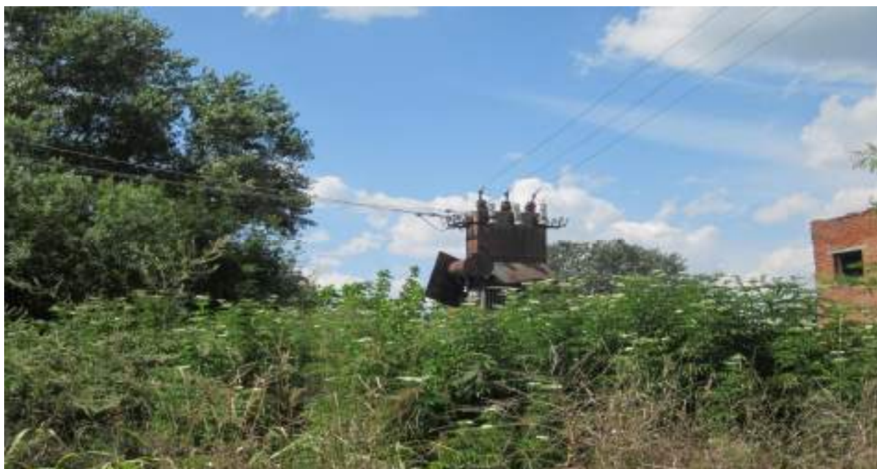
Трансформаторная подстанция – 100 кВт. ул.Полевая. Ржавый, весь зарос.
