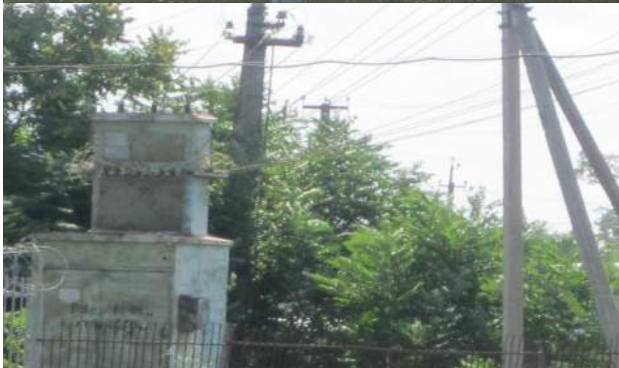
Трансформаторная подстанция – 160 кВт. с.Натырбово. ул.Янпольского-Колхозная. 2 столба стоят под углом 2°
