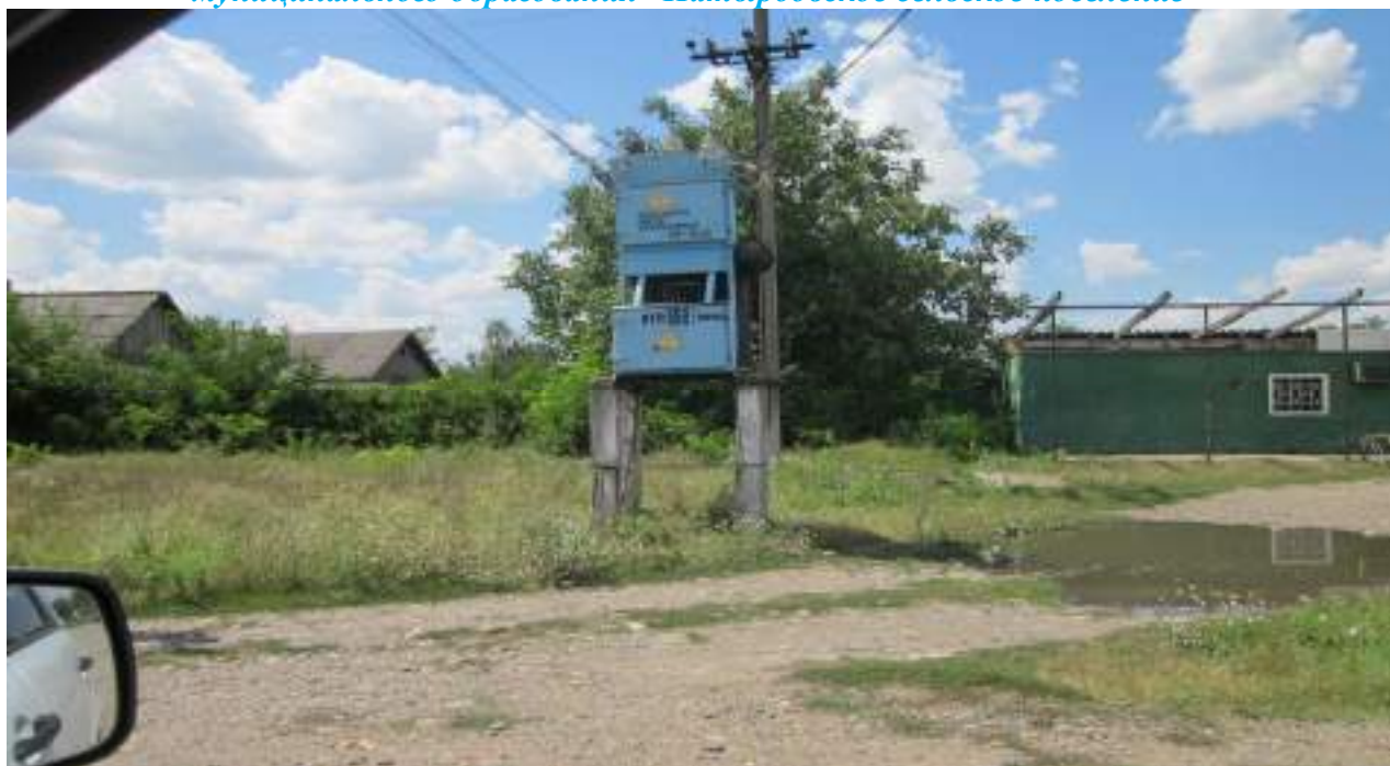
Трансформаторная подстанция – 100 кВт. ул.Гагарина. ТП замаслен, нет надписей.
