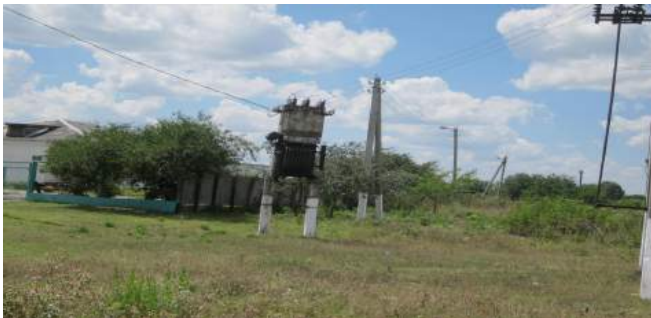
Трансформаторная подстанция – 100 кВт. Замаслен. Стоит под наклоном.
