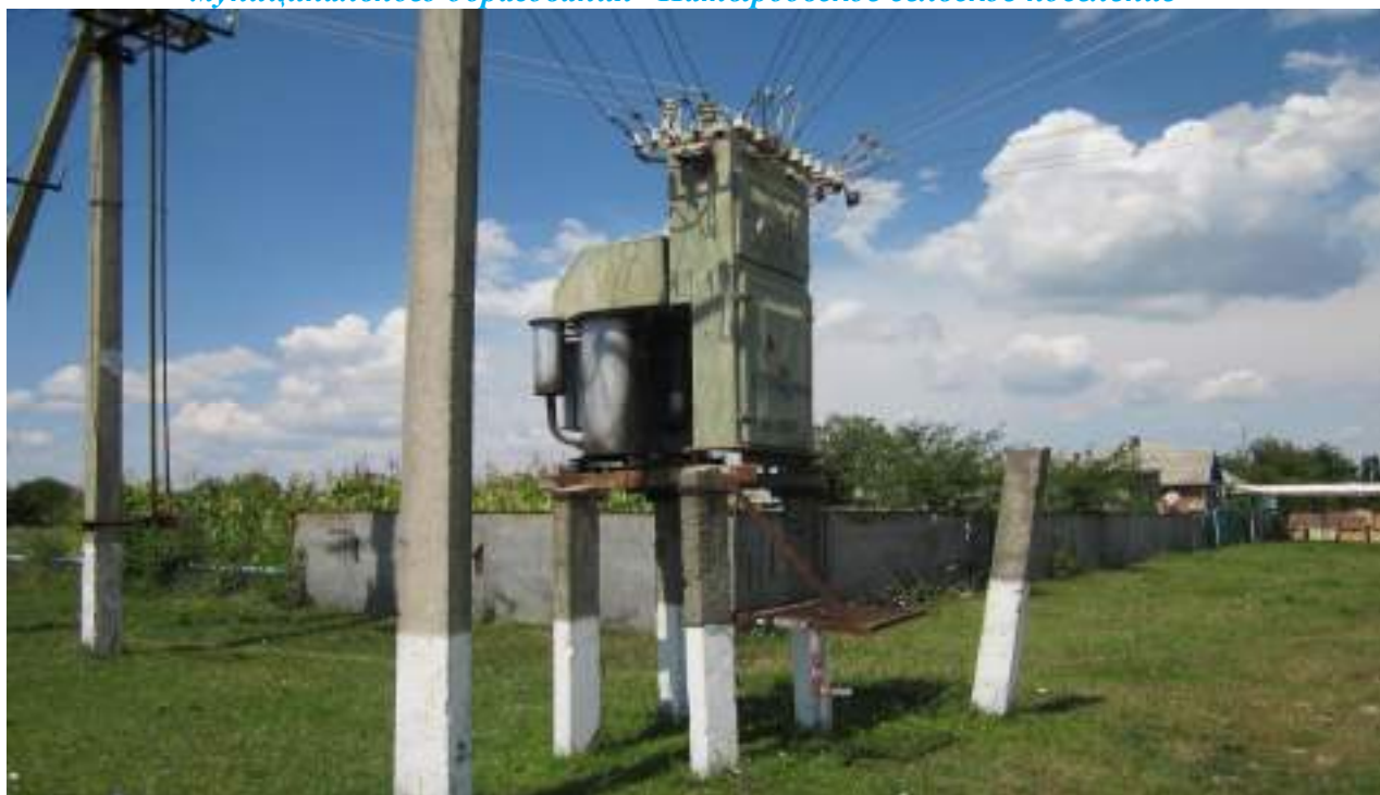
Трансформаторная подстанция – 160 кВт. с.Натырбово. ул.Пушкина и Кирова. ТП замаслен. Нет надписей.
