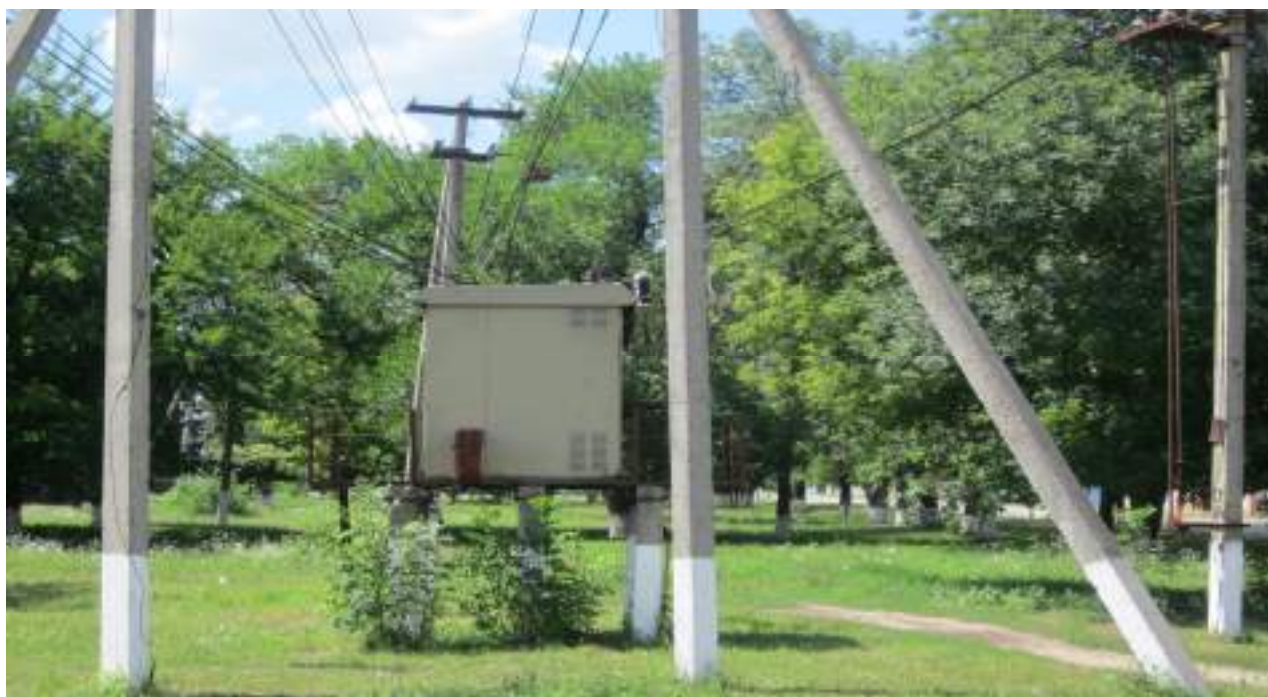
Трансформаторная подстанция – 160 кВт. с.Натырбово. ул.Янпольского и Воронина. Отсутствуют надписи.
