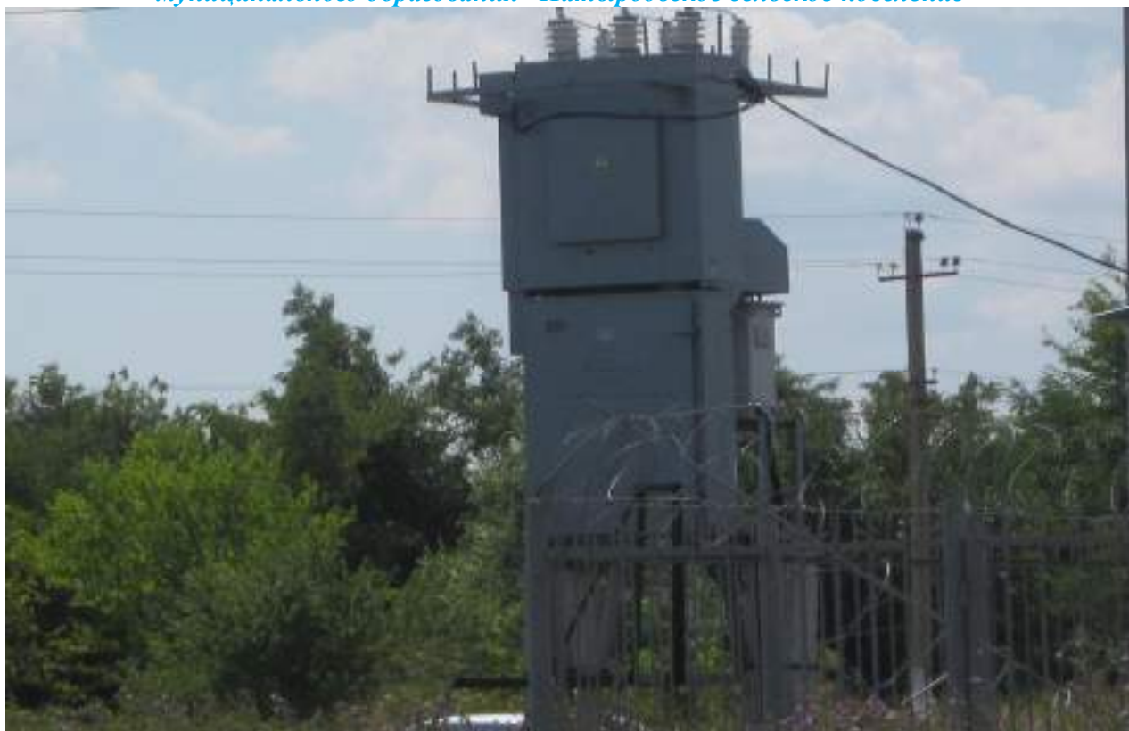
Трансформаторная подстанция – 60 кВт. п.Казенно-Кужорский
