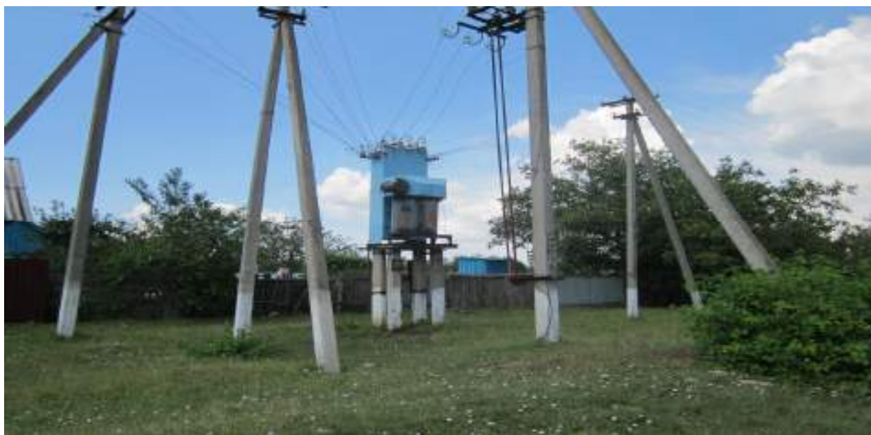
Трансформаторная подстанция- 100 кВт. с Натырбово. Ул.Гоголя и Советская. ТП замаслен. Нет надписей
