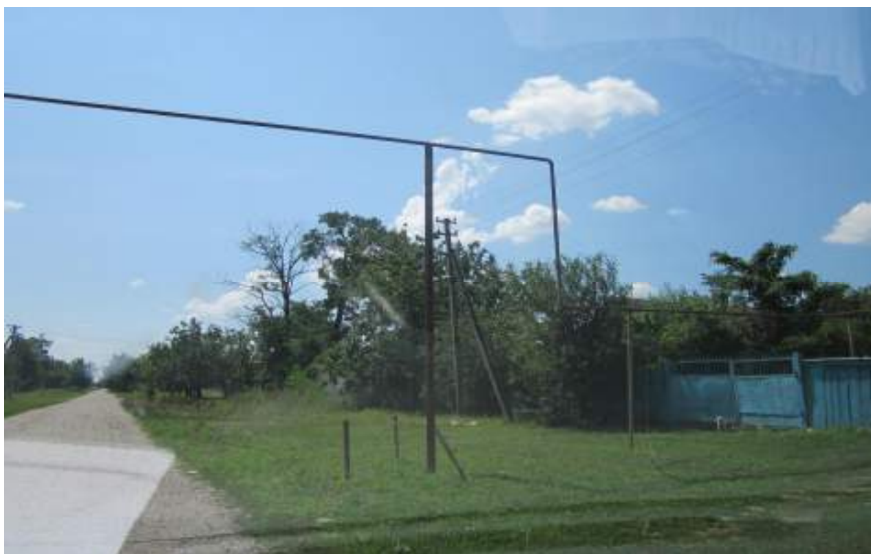
Газопровод. с.Натырбово. Непокрашен.
