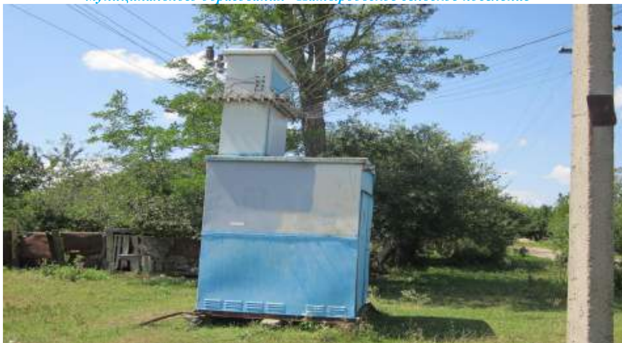
Трансформаторная подстанция – 160 кВт. с.Натырбово. пересечение ул.Партизанская-Кирова. Нет надписей.
