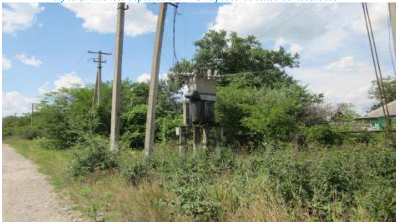
Трансформаторная подстанция – 100 кВт. п.Казенно-Кужорский. ул.Крупской.ТП замаслен, изолятор висит. Нет надписей.
